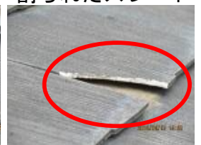
(屋根材) 割られたスレート
